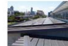
たまでん3号発電所
